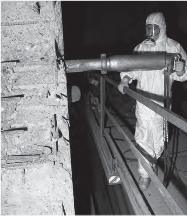
Décollement du béton.
